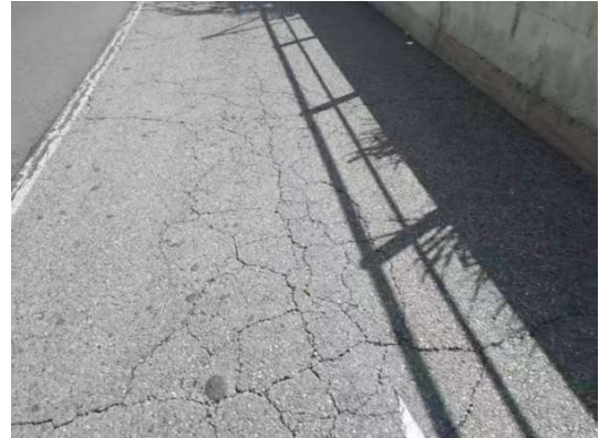
Area non ricoperta con evidenza fessurazioni
