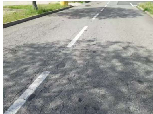
Fessurazioni e buche nel tratto tra imbocco Sud ed imbocco Nord di Strada Ortofrutta Nord
