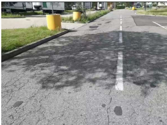
Fessurazioni e buche nel tratto tra imbocco Sud ed imbocco Nord di Strada Ortofrutta Nord
