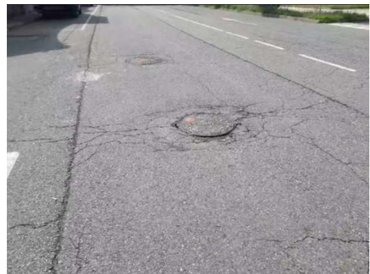
Pozzetti e fessurazioni – Edificio 11 parte Est
