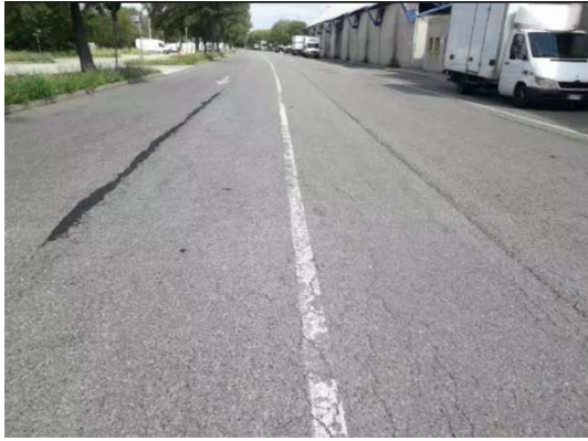
Area con evidenti fessurazioni – Edificio 11 parte centrale
