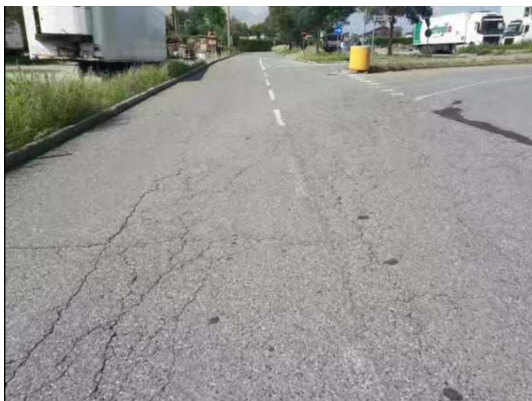
Area gravemente fessurata all'incrocio con Strada Uffici
