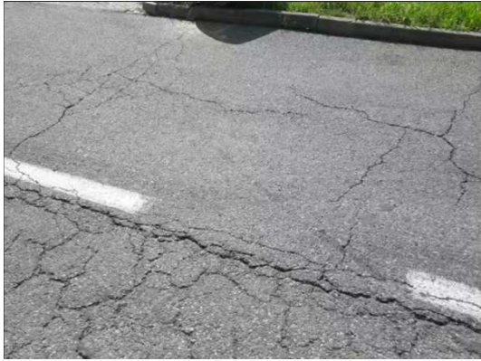
Area gravemente fessurata in prossimità di ingresso Sud verso Strada Ortofrutta Sud
