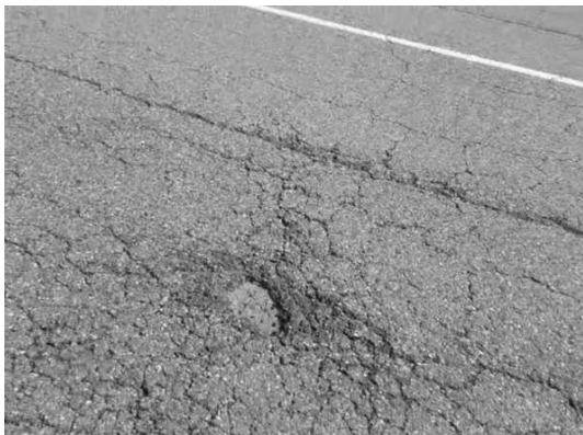
Buca e fessurazioni
