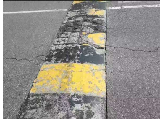
Area con danneggiamento
