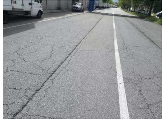
Area con evidenti fessurazioni – Edificio 11 parte centrale
