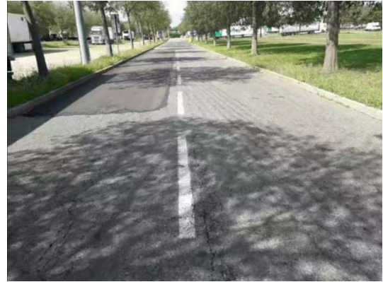
Area parzialmente ricoperta per ridurre avvallamenti e buche zona Fronte ingresso Ovest Edificio 01
