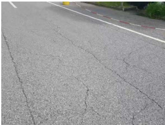
Area tra Ed 11 ed Edificio 12 – Fessurazioni area Serra Aeroponica
