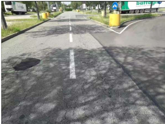
Area gravemente fessurata con buca ricoperta in prossimità di ingresso Sud verso Strada Ortofrutta Nord
