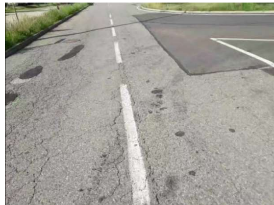
Area gravemente fessurata con buche ricoperte in prossimità di ingresso Nord verso Strada Ortofrutta Nord
