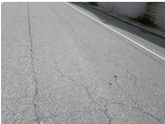
Area con evidenti fessurazioni – Edificio 11 parte Est
