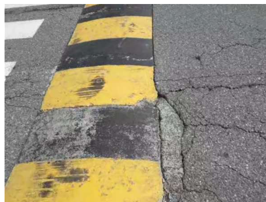
Area con danneggiamento
