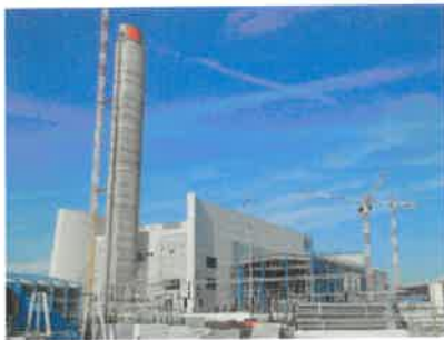
TRM Spa – Nuovo Termovalorizzatore del Gerbido (TO)
